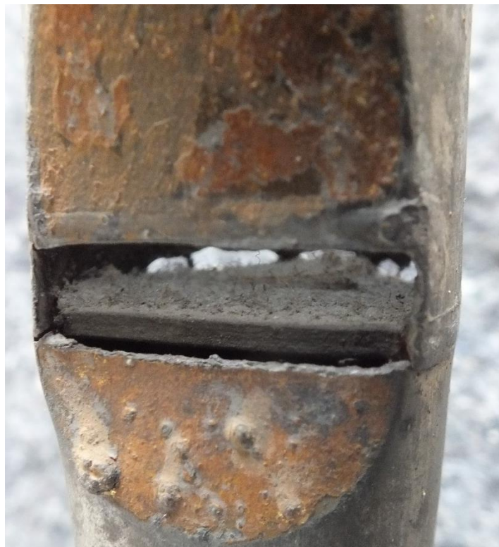
Photo 76: Brebos façade pipe
