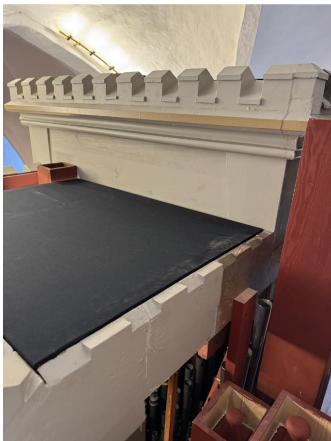
Nyt orgelhus ”tag” i form af højtalerstof, udspændt på træramme, endvidere ny afslutning af massiv fyr, på sider af orgelhusets midterfelt.
